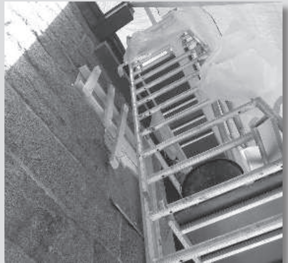
Kappelin seinän halkeama oli suurempi kuin luultiin.
