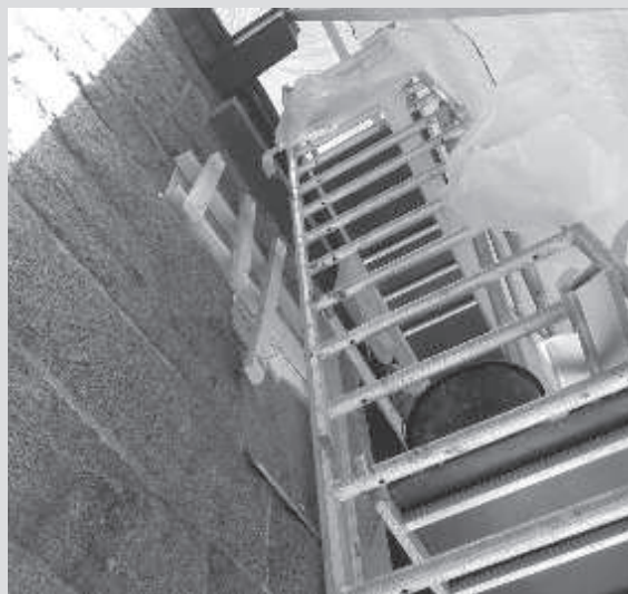
Kappelin seinän halkeama oli suurempi kuin luultiin.
